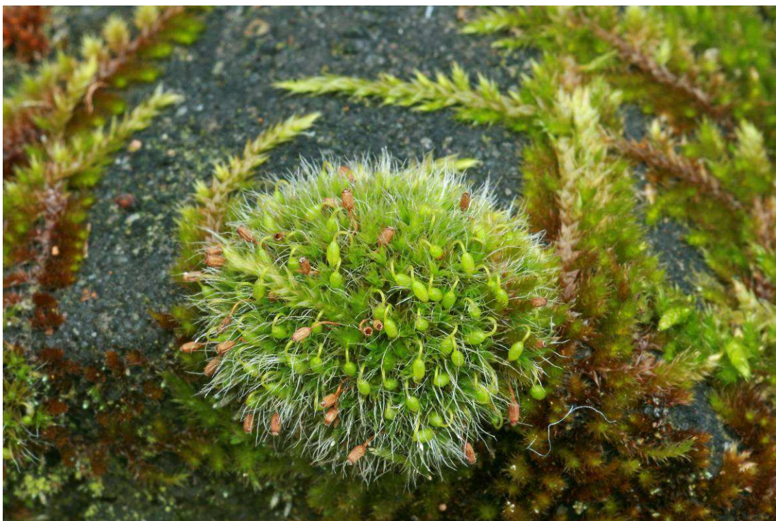
fig.179 Gewoon muisjesmos tussen Gesnaveld klauwtjesmos op een betonpannendak.
