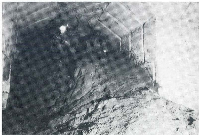
Ingespoelde modder onder schacht
