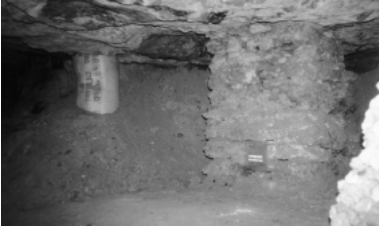
Weitungsbau met een gemetselde pijler uit de tijd van Goethe. Rechts een Bullflex pijler.
