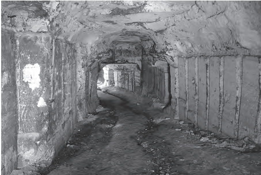
AFBEELDING 13: De aflopende gang, gelegen direct achter de toegangspoort van de Grote Berg. De verlaging in het plafond (midden) is de doorbraaklocatie (foto Peter Jennekens)
